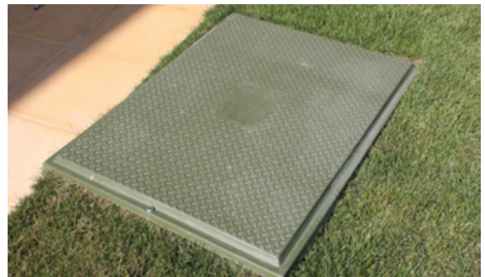
Locale tecnico interrato
